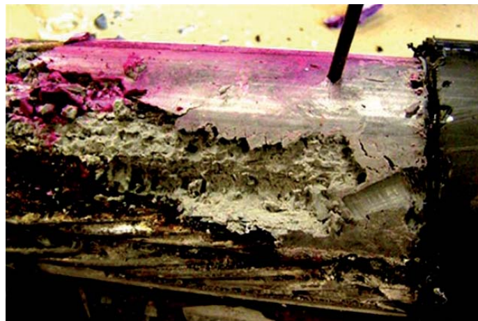
Rys. 5. Stan iniektu w zewnętrznym kablu sprężającym most Ringling Causeway na Florydzie (kolor różowy wystąpił pod wpływem fenoloftaleiny; świadczy, że pH iniektu jest w zakresie 8,2–12,0; z prawej strony, u góry widać śrubokręt wciśnięty w miękki iniekt) [FHWA-HRT-14-039, May 2014]
