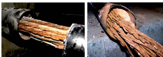
Rys. 1. Skorodowane cięgna zewnętrznego kabla sprężającego dźwigary mostu Verina Enon na Florydzie, USA [J. Pouliotte, Department of Transportation State of Florida]
