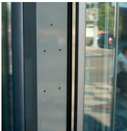
Rys. 5. Niezabezpieczone otwory, swobodny dostęp powietrza może powodować lokalną kondensację pary wodnej i zawilgocenie elementów
