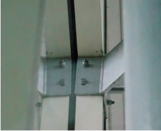
Rys. 2. Nieodpowiednio, krzywo przymocowany element stalowego okucia węzłowego, źle dobrana długość śrub, brak przekładek zapobiegających powstawaniu ognisk korozji
