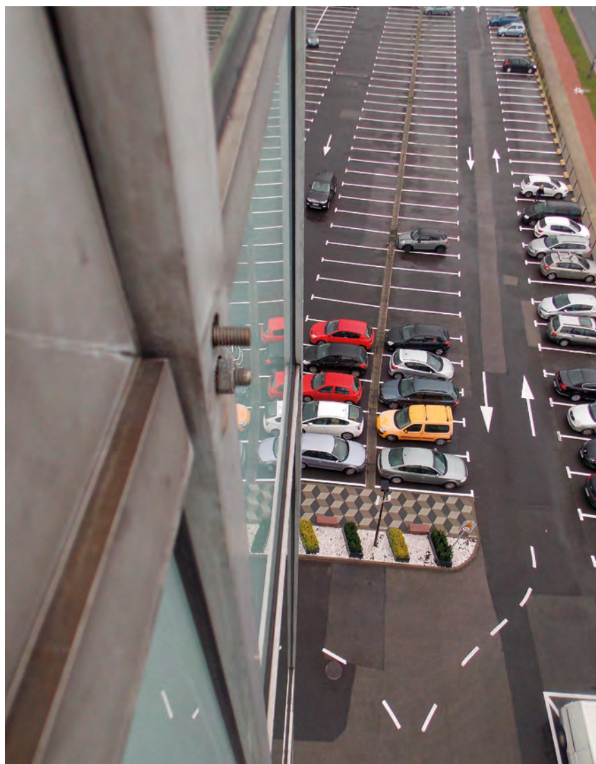
Rys. 1. Mocowanie listwy maskującej do elementów fasady, brak nakrętki na jednym z łączników
