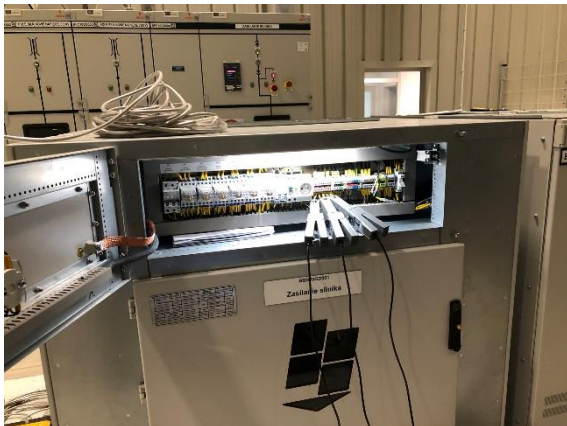
Rys. 2. Widok zamontowanych cęgów do pomiaru prądów w obwodzie wtórnym przekładników prądowych
