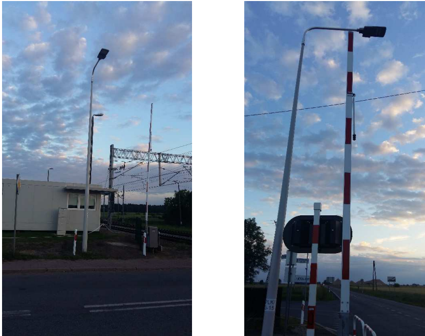
Rys. 2. Nowoczesne oprawy oświetleniowe typu LED na słupach kompozytowych na przejeździe kolejowo-drogowym
