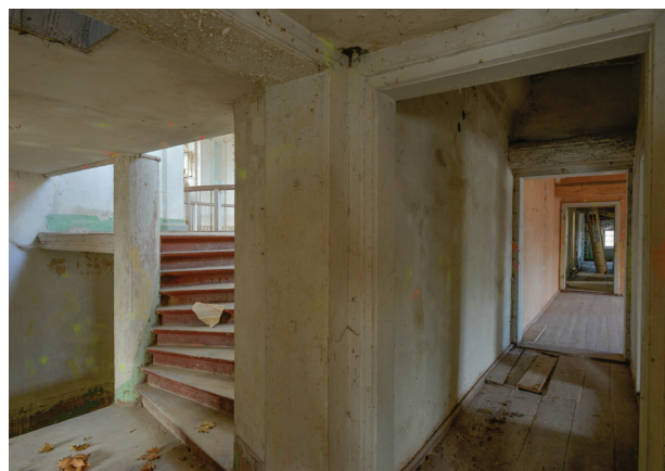
Il. 8. Pałac Seherr-Thossów w Szymanowie. Widok na międzykondygnacyjny system komunikacji wertykalnej (fot. J.K. Kos, 2019)
