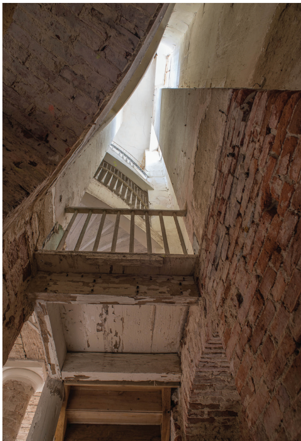
Il. 9. Pałac Seherr-Thossów w Szymanowie. Widok na świetlik z poziomu piwnicy (fot. J.K. Kos, 2019)
