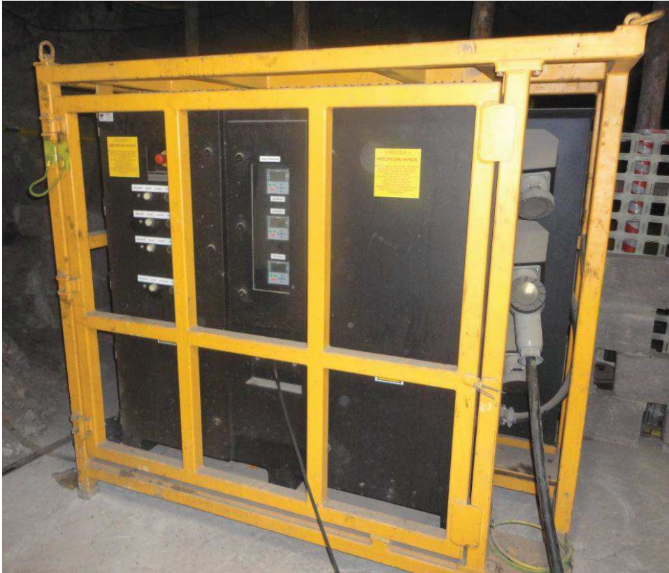
Rys. 4. Moduł ładowania zainstalowany w podziemiach kopalni [2]
