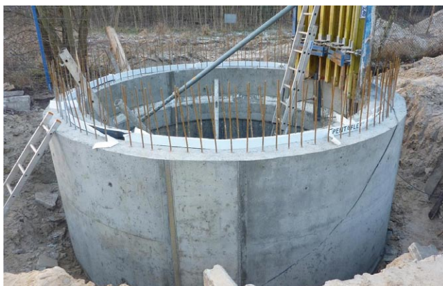
Rys. 2. Prace budowlane przy opuszczaniu studni w Suchym Lesie, k. Poznań; pierwszy segment studni został już opuszczony, w prze-wie technologicznej zastosowano taśmę z blachy ocynkowanej [1]
