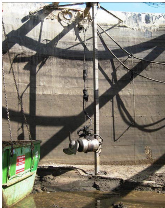
Fot. 9. Zdegradowany zbiornik żelbetowy (Fot. autor 2015)
