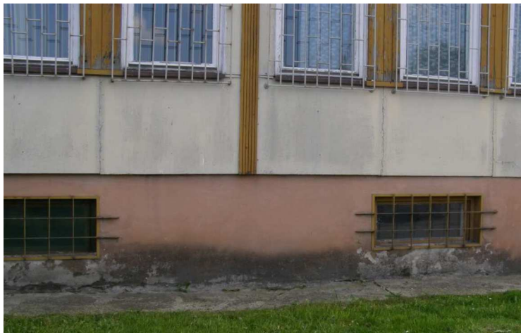
Rys. 1. Budynek dotknięty zjawiskiem podciągania kapilarnego (opracowanie własne)
