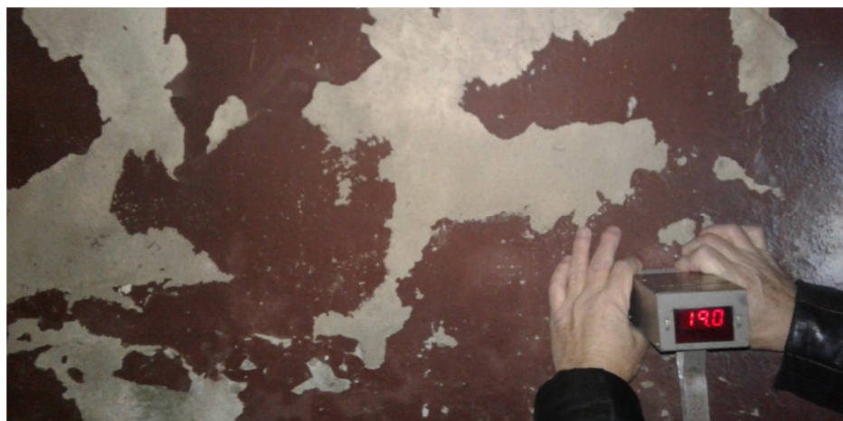
Rys. 8. Tynk pokryty farbą akrylową, fot. autor, grudzień 2016
