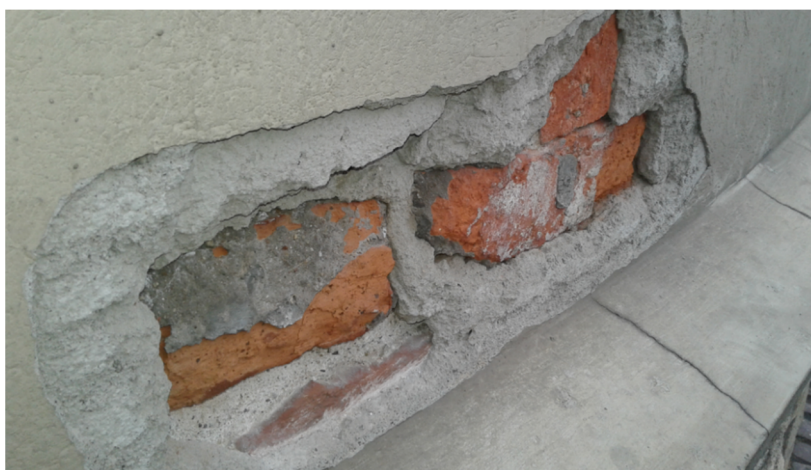
Rys. 3. Odspojenie tynku, fot. autor, październik 2016
