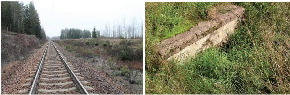
Rys. 5. Przykłady wad odwodnienia: zarośnięty rów odwadniający (po lewej) oraz niedrożny przepust (po prawej) [15]
