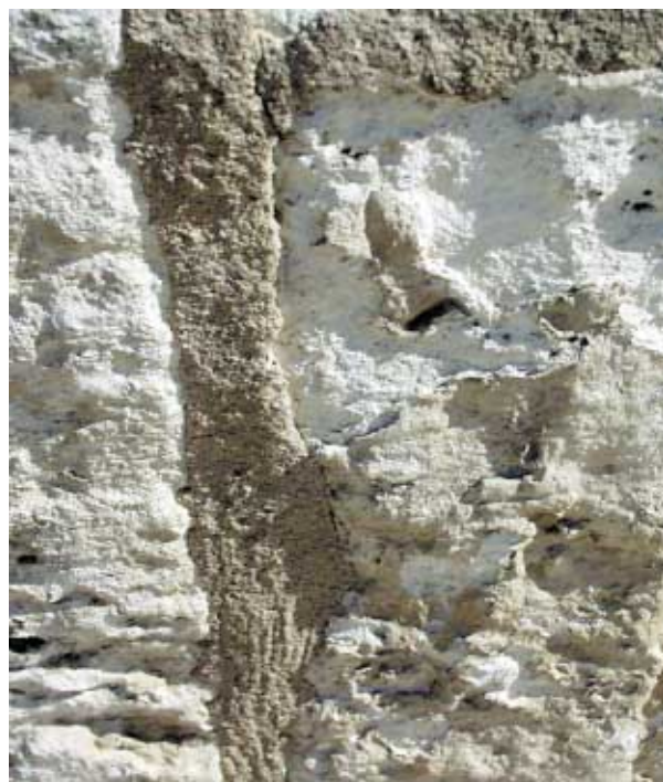
Rys. 18. Solne wykwity na powierzchni wapienia
