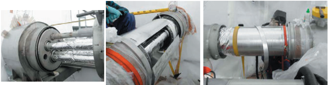
Rys. 11. Izolacje termiczne rur procesowych i ekranu
