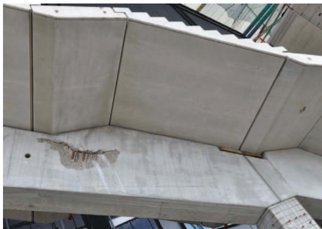
Rys. 8. Odspojenie betonu w połączeniu belki ze spocznikiem (zdjęcie autorów)
