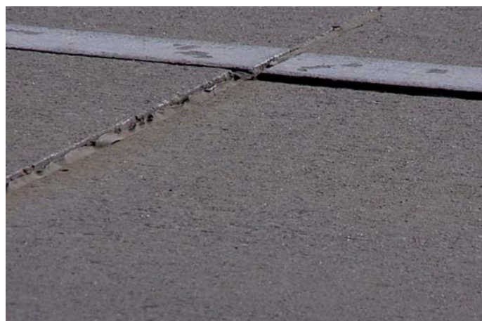
Fot. 7. Przykład klawiszowania płyt betonowych na nawierzchni autostrady [7]
