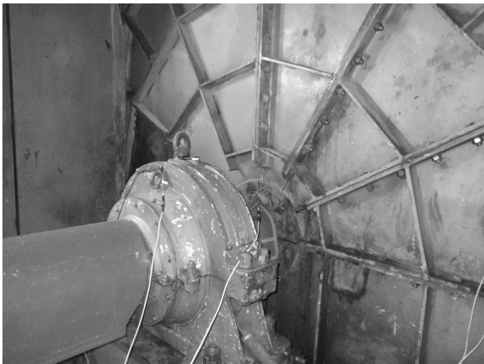
Rys. 5. Czujniki na kanale 2 i 3
