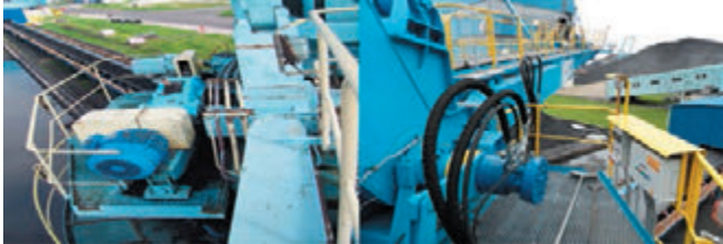
Rys. 2. Modernizacja napędu przenośnika załadunkowego (po lewej stronie przed modernizacją, po prawej stronie po modernizacji) [1]
