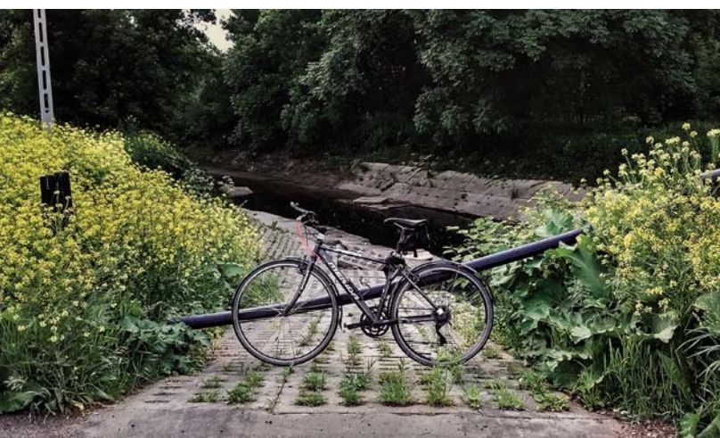
Koryto rzeki Jasień – nawierzchnia wymagająca poprawienia Źródło: archiwum autorki.
