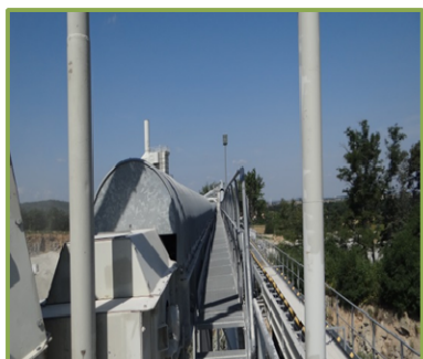
Rys. 8. Obudowy i osłony przenośnikowe w kopalni Wieśnica (fot. M.Stefanicka)
