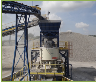
Rys. 2. Widok węzła III stopnia kruszenia w kopalni Łaźany - praca pod pełnym obciążeniem i zraszaniem nadawy (fot. M. Stefanicka)
