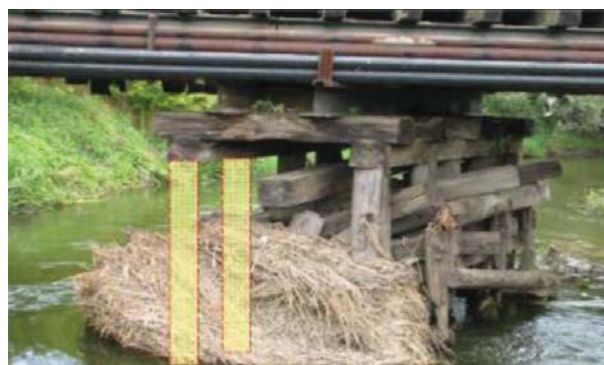
Rys. 6. Widok filara wraz z zaznaczonymi brakami pali, stan w 2009 roku. Źródło: [4]
