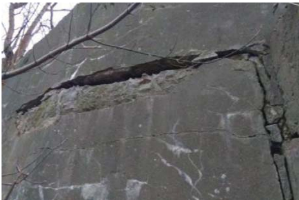
Rys. 9. Przykładowe uszkodzenia przyczółków. Źródło: [6]
