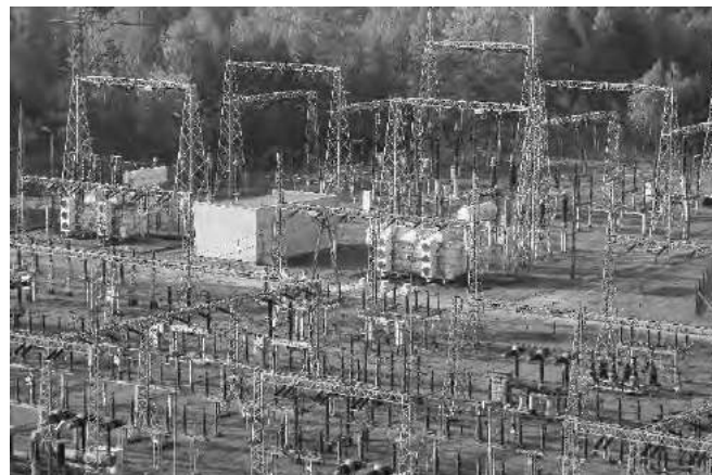
Rys. 6. Widok na rozdzielnię 110/220 kV elektrowni Halemba
