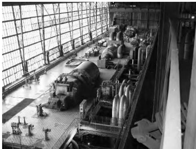
Rys. 4. Widok na maszynownię elektrowni Halemba
