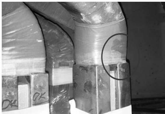
Rys. 7. Pręt stojana generatora z zanieczyszczeniem powierzchniowym izolacji
