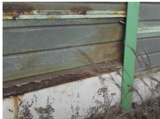
Rys. 1. Ekran akustyczny poddany oddziaływaniom meteorologicznym oraz czynnikiem związanym z utrzymaniem pasa drogowego.
