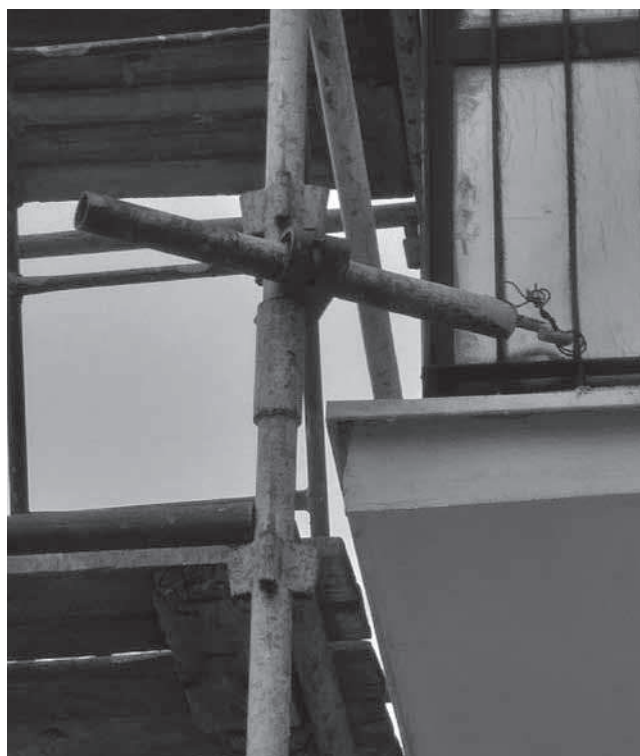
Rys. 3. Nieprawidłowe kotwienie za pomocą drutu do barierki rusztowania; łącznik kotwiący zamocowany pod kątem innym niż prosty
