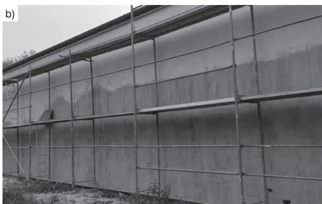
Rys. 2. Nieprawidłowości w montażu zabezpieczeń: a) brak balustrady od wewnątrz oraz od czoła, brak desek krawężnikowych, b) niekompletne balustrady lub ich brak; w rusztowaniu na rysunku 2a wystający poza narożnik fragment rusztowania nie został zamocowany do ściany budynku
