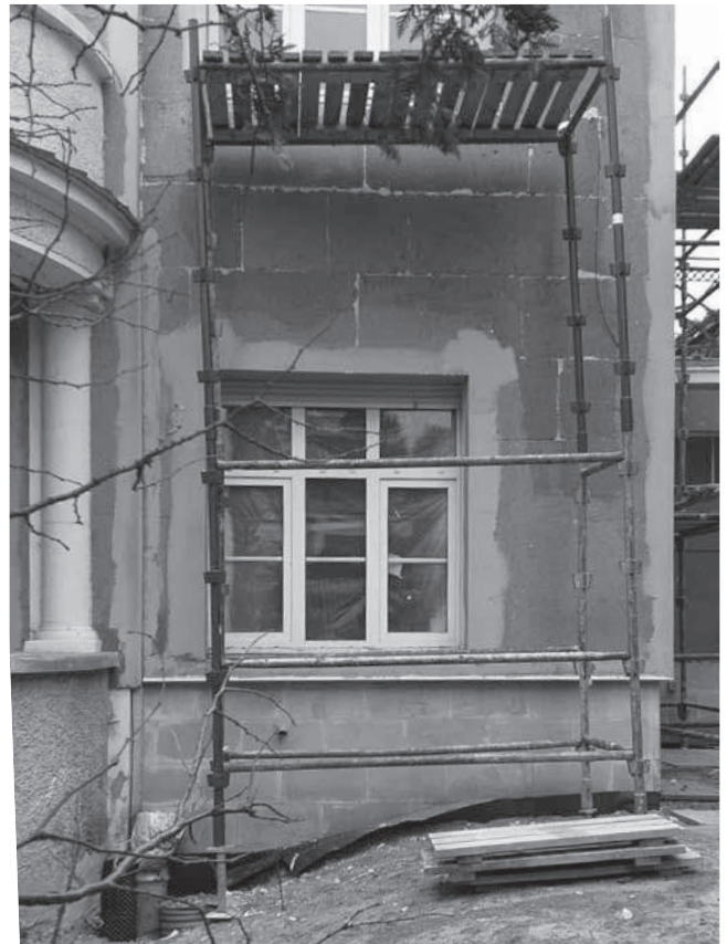
Rys. 4. Nieprawidłowo zmontowane rusztowanie: nieprawidłowe posadowienie, brak stężeń pionowych, brak prawidłowej komunikacji na rusztowaniu, brak balustrad
