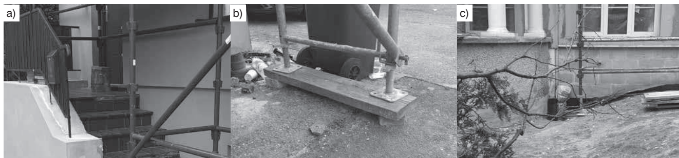
Rys. 1. Przykłady nieprawidłowego posadowienia: a) na pieńku drewna, b) podkład ułożony na ceglach, c) bez wykonania tarasu na nachylnym gruncie, bez podkładu, podstawka nie przylega całą powierzchnią do podłoża
