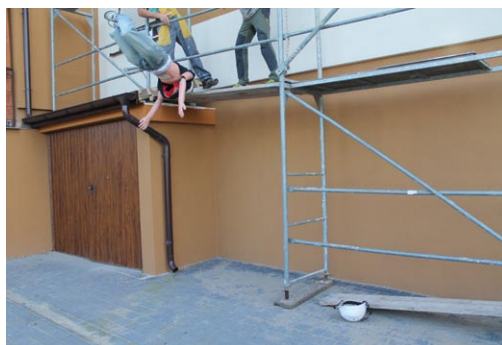
Rys. 3. Upadek poszkodowanego gdy siedział na poręczy
