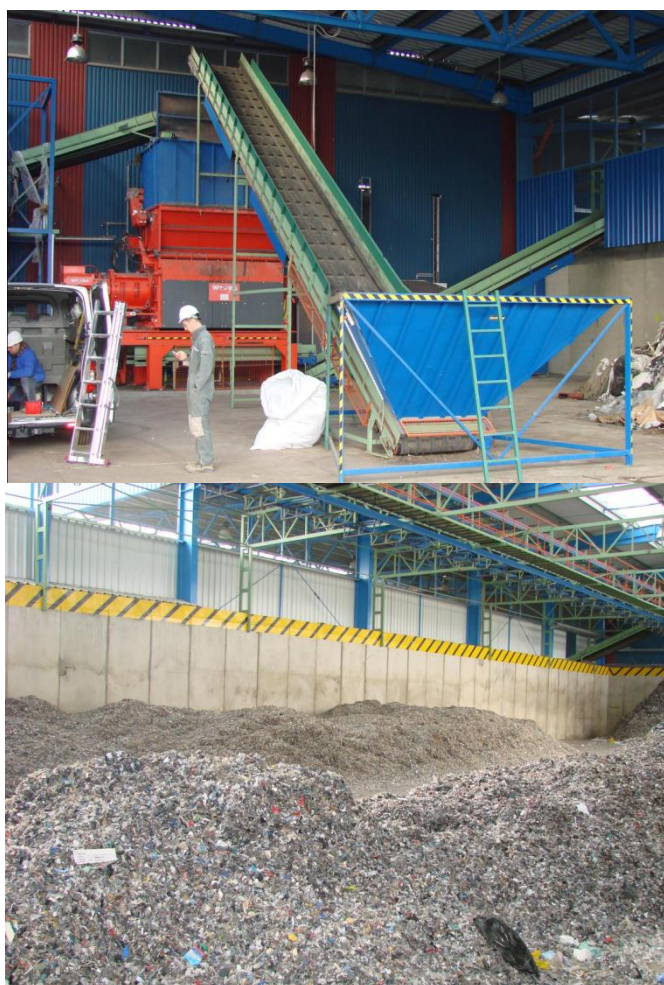
Rys. 3.3 Rozdrabniacz zastosowany w linii technologicznej ZUO w Gorzowie Wielkopolskim (po lewej) i widok paliwa alternatywnego w magazynie (po prawej)
