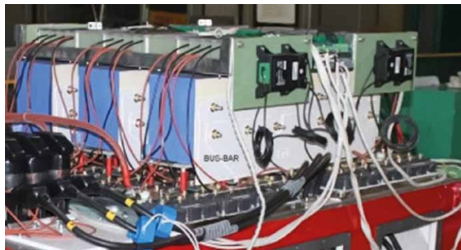
Rys. 4. Zespół przekształtnikowy zintegrowanego napędu na napięcie 3,3 kV
