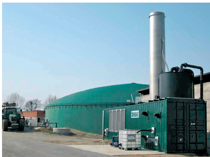
Rys. 9. Biogazownia firmy Farmatic (w Polsce: City Energy)
