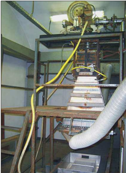
Fot. 1. Widok ogólny akceleratora ELEKTRONIKA
