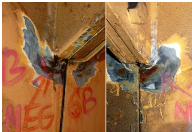
Rys. 5. Miejsca badań magnetyczno-proszkowych styków belek torowiska z uwidocznionymi pęknięciami
