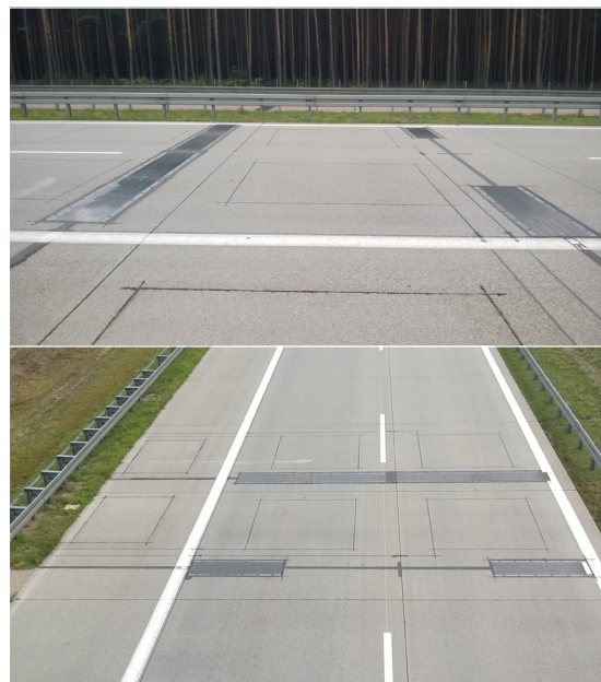
Rys. 4. Obecne rozmieszczenie płyt tensometrycznych, wyznaczających masę pojazdu, na pasie północnym autostrady A2 – kierunek Świecko
