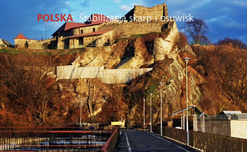
Zabezpieczenie zamku w Dobczycach przed obrywami skalnymi przy przyczółku zapory – kotwienia mikropalami TITAN, fot. Titan Polska Sp. z o.o.
