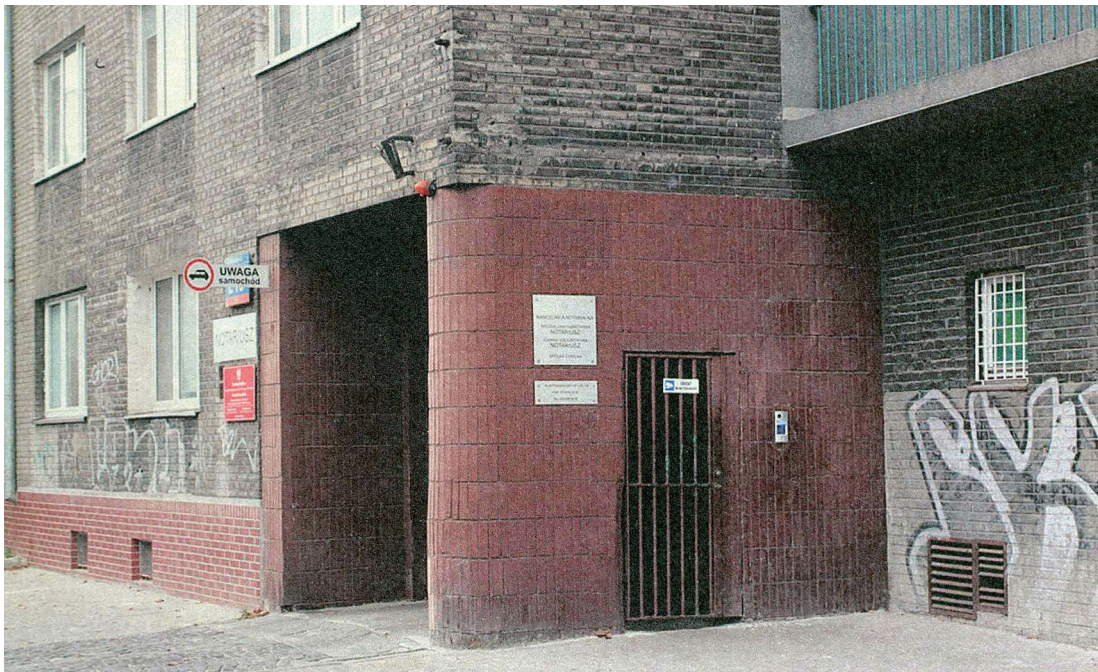
Ilustracja 7. Warszawa. Wielomieszkaniowy budynek przy ulicy Koszykowej 79A/Alei Niepodległości 245, widok wejścia od strony Alei Niepodległości. Okładzina klinkierowa została pokryta farbą. Fot. Alicja Szmelter, 2016
