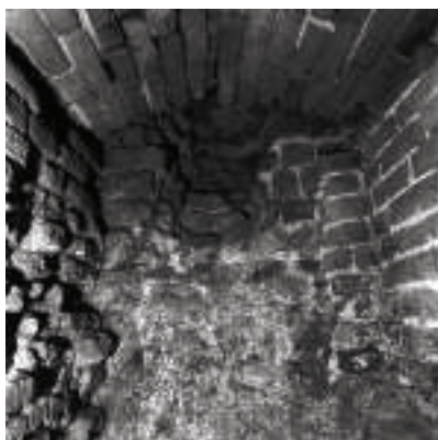
Ryc. 16. Północna ściana magistralna piwnicy (i pieca) z wtórnie wykutym kanałem dymowym pieca. Fot. Archiwalna T. Szklarczyk 1989 Fig. 16. The north load-bearing wall of the cellar (and the stove) with a secondarily made flue from the stove. Photo: archive, T. Szklarczyk 1989
