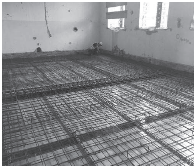
Rys. 6. Zbrojenie płyty żelbetowej w budynku przy ul. Lastadia 2 w Gdańsku (zdjęcie: autor)
