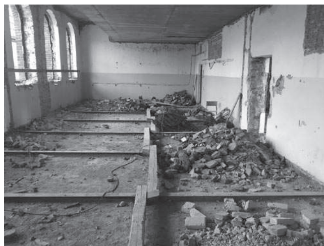
Rys. 4. Widok stropu nad I piętrzem w budynku przy ul. Lastadia 2 w Gdańsku, stan na 30.07.2018 r. (zdjęcie: autor)
