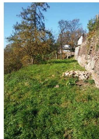
Rys. 5. Widok ceglaneanego muru oporowego i terenu za skarpg
