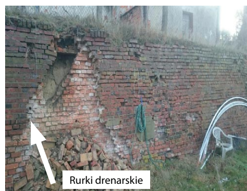
Rys. 6. Miejsce największego uszkodzenia muru
