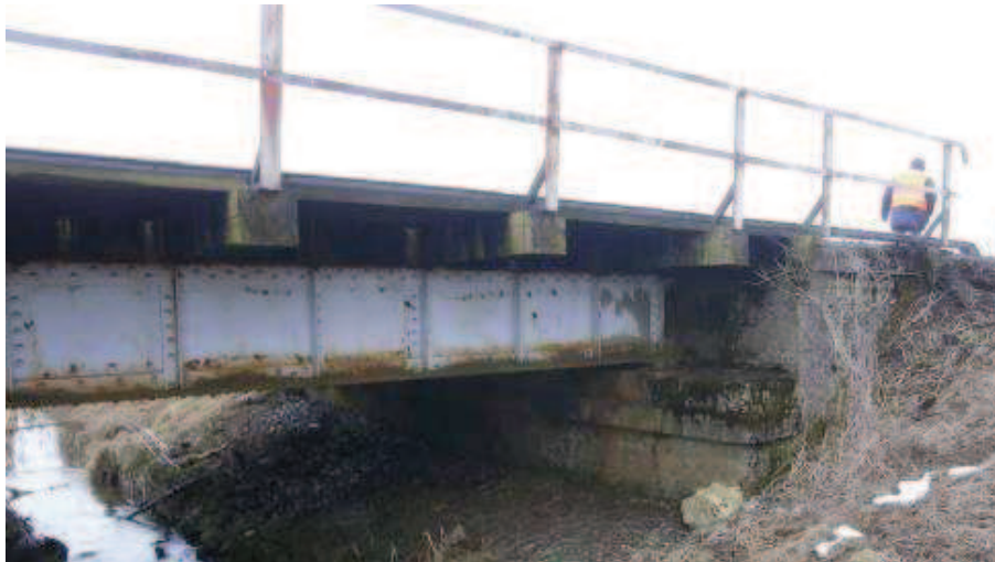
Rys. 6. Most w km 5,311 (stan przed remontem)
