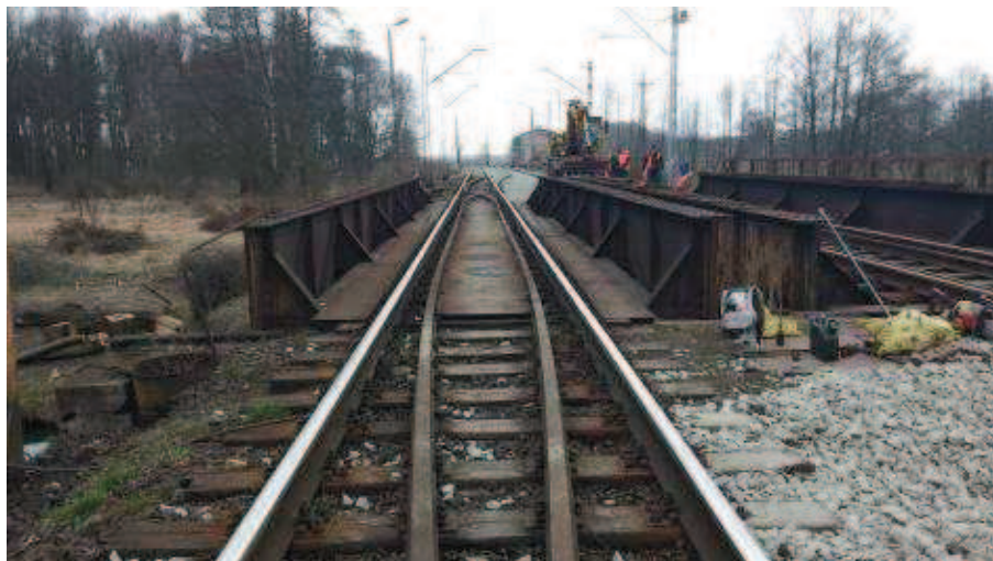
Rys. 8. Most w km 22,980 (stan przed remontem)
