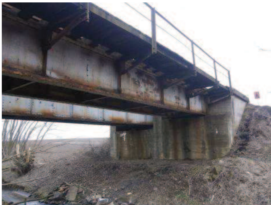
Rys. 5. Most w km 4,010 (stan przed remontem)
