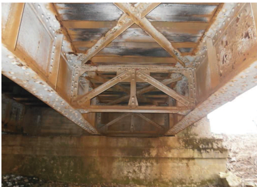
Rys. 7. Most w km 5,311 (stan przed remontem)
