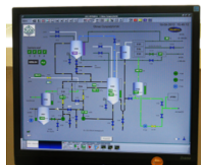
Fot. 5. Obraz dyspozytorski instalacji w trakcie działania
