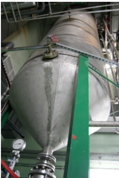
Fot. 7. Fragment instalacji wyparnej
