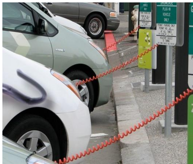
Rys. 1. Stacja ładowania pojazdów elektrycznych małej mocy, czas ładowania 6-8 godzin [11]
