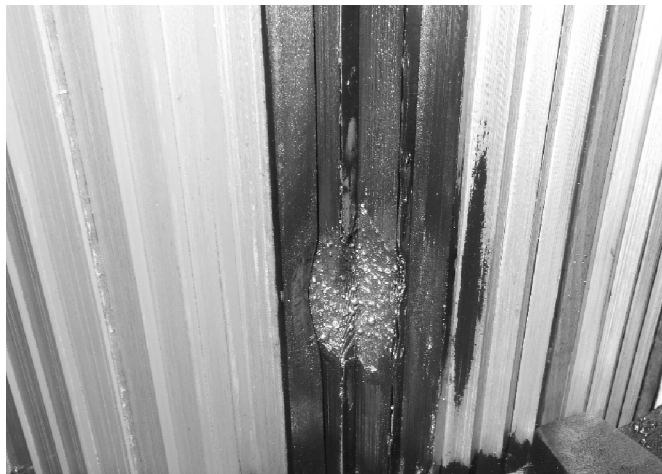
Rys. 10. Widok uszkodzonego rdzenia
