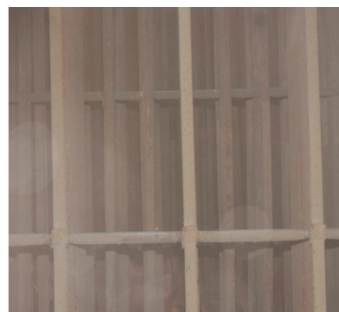
Fot. 4. Przegrzewacz - cztery miesiące pracy i godzina po wyłączeniu kotła. Brak osadów i uszkodzeń powłoki
