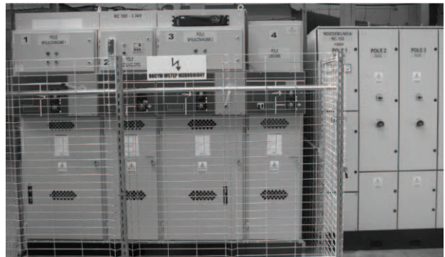
Rys. 9. Zmodernizowana instalacja elektryczna w hali badawczej [źródło: fot. KOMAG]
