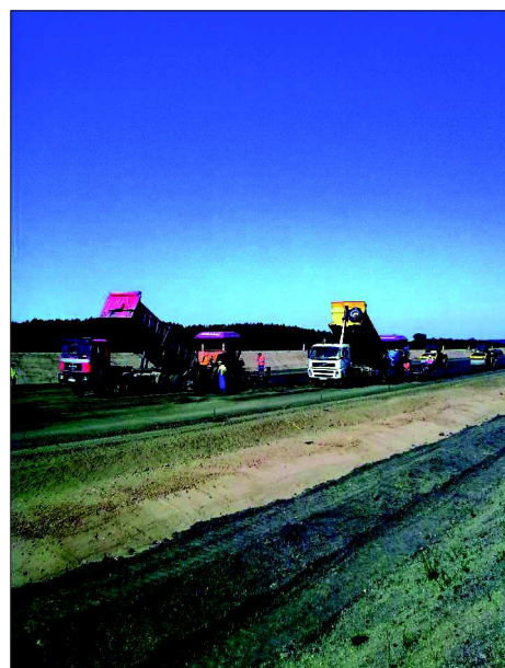
Fot. 2. Wykonanie podbudowy z chudego betonu z zastosowaniem dwóch układarek do mma (fot. St. Rewiński)
