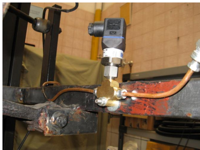
Rys. 5. Przetwornik ciśnienia zamontowany w układzie
