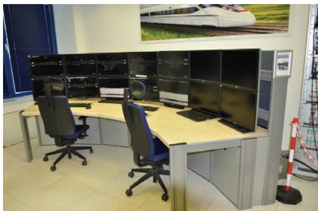
Rys. 4. Stanowisko do testowania systemów bezpieczeństwa ruchu na terenie zakładu Bombardiera ZWUS w Katowicach [fot. M. Graff, 30.05.2017 r.]
