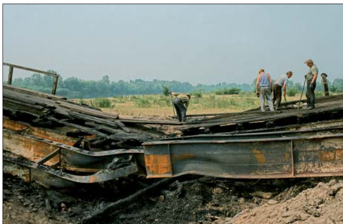
Fot. 10. Zdeformowane dźwigary stalowe mostu po pożarze (fot. M. Mistewicz 1990 r.)
