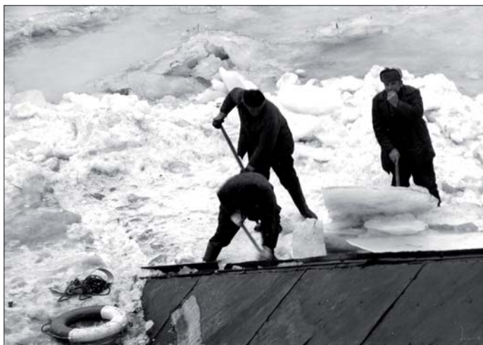
Fot. 7. Wykonywanie bruzd w lodzie przed izbicami mostu w Wyszogrodzie (fot. G. Małetka 1982 r.)
