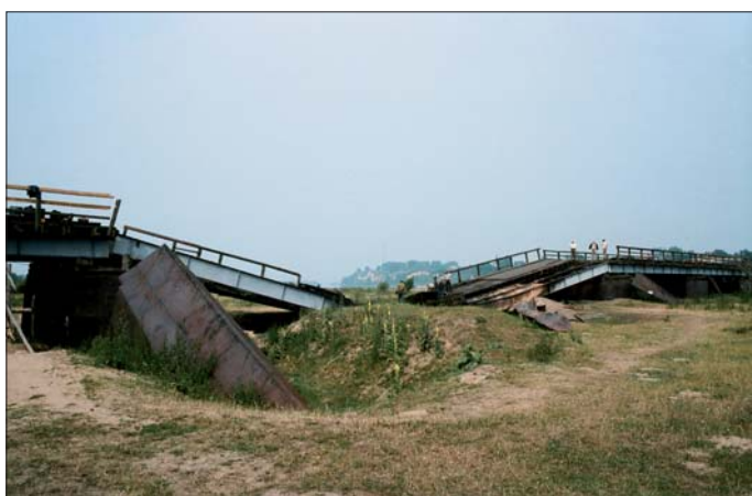
Fot. 9. Katastrofa dwóch przęseł mostu w Wyszogrodzie w wyniku pożaru (fot. M. Mistewicz 1990 r.)
