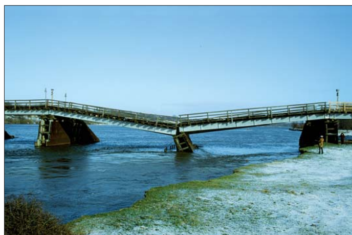
Fot. 13. Zniszczony filar i dwa przęsła mostu wskutek przemieszczenia koryta Wisły podczas pochodu lodów (fot. M. Mistewicz 1993 r.)
