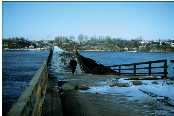
Fot. 15. Ruch po moście wyłączonym z użytkowania po pochodzie lodów (fot. M. Mistewicz 1993 r.)
