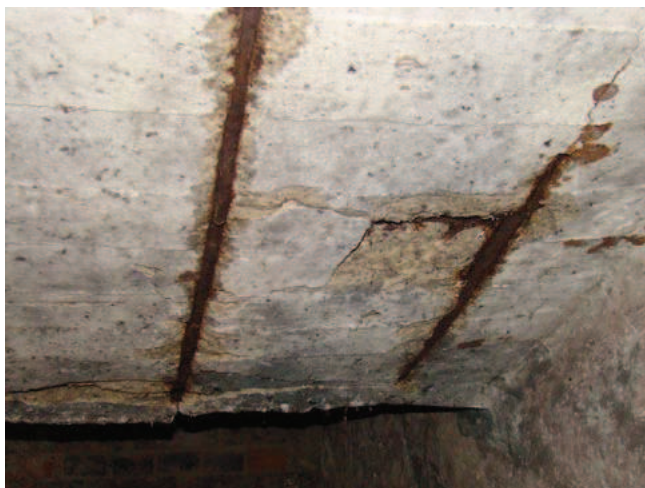
Rys. 5. Zbrojenie płyty biegowej klatki schodowej – widoczny brak otuliny oraz zwiększony rozstaw prętów zbrojenia głównego, brak prętów rozdzielczych (fot. Maciej Niedostatkiewicz)
