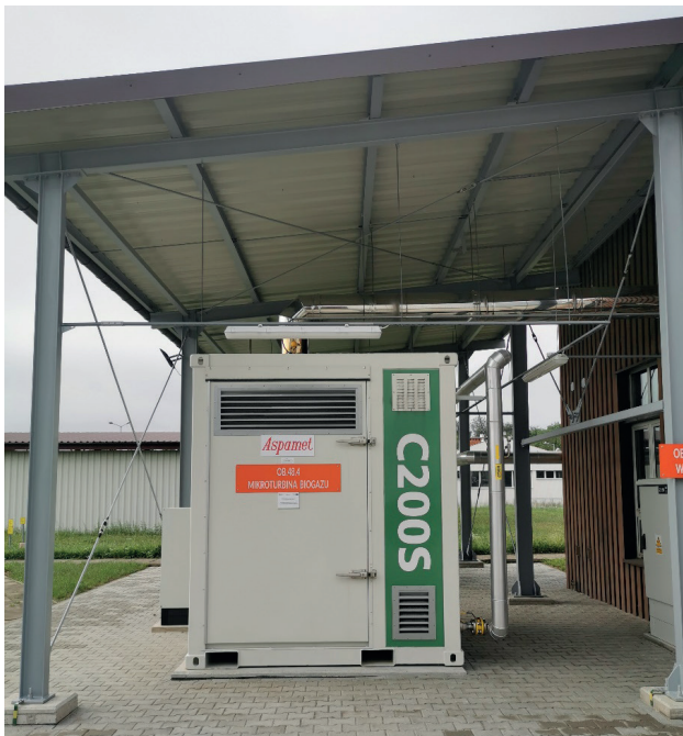
Rys. 5. Turbina o mocy 200 kW zasilania biogazem
