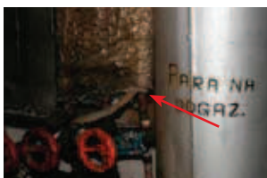
Rys. 3. W powierzonych oględzinach sznur jako izolacja na przewodach parowych jest niewidoczny
