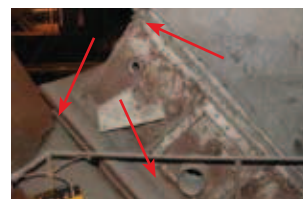
Rys. 4. Uszczelki na połączeniach elementów kotłów
