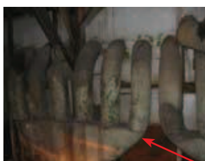
Rys. 5. Płaszcz azbestowo-cementowy na odprowadzeniu spalin
