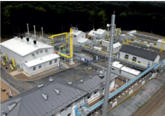
Rys.3 Inwestycja po rozpoczęciu tłoczenia gazu 05-2012 [6] Fig.3 The investment after the start of gas pumping 05-2012 [6]
